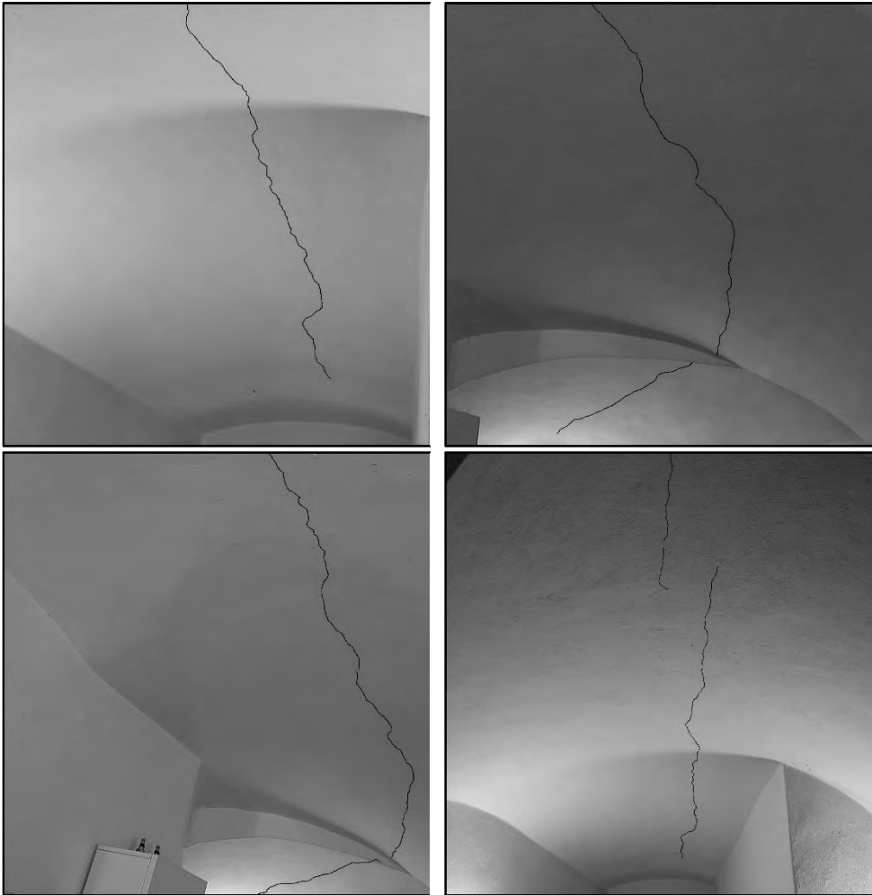
Slika 10. Oštećenja stropnog svoda zapadnog tornja u razini prizemlja
