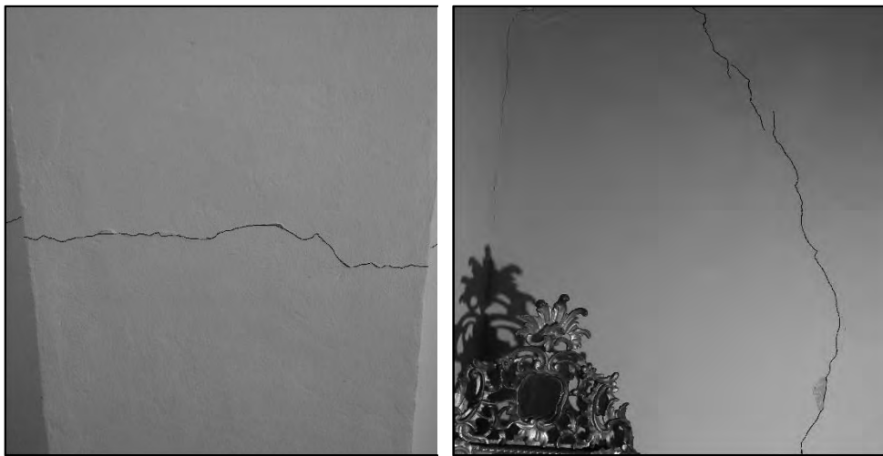
a) tanka pukotina širine < 1\text{mm} u vrhu luka; b) pukotina širine < 3\text{mm} na zidu drugog kata
